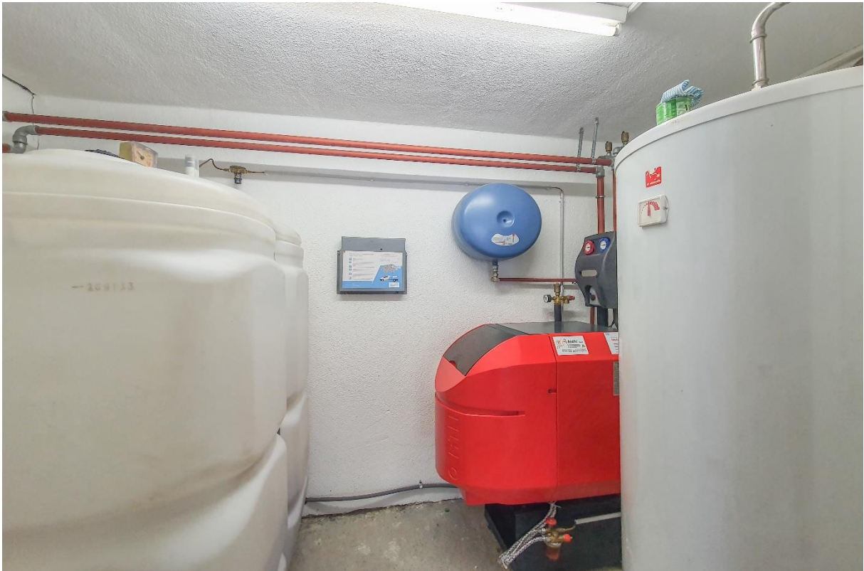
Der Technikraum mit Heizung, Tank und Boiler
