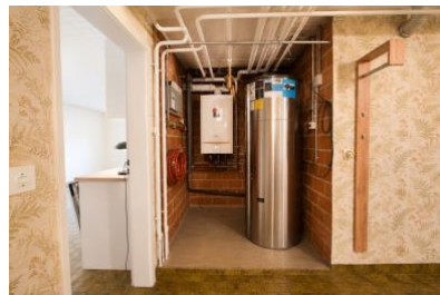
Heizzentrale und Wärmepumpenboiler 2023
