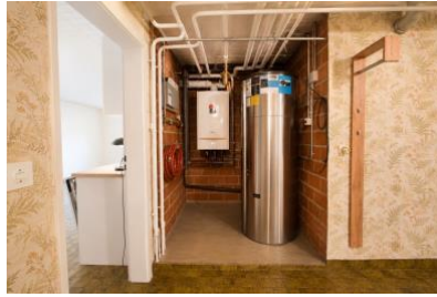
Heizzentrale und Wärmepumpenboiler 2023
