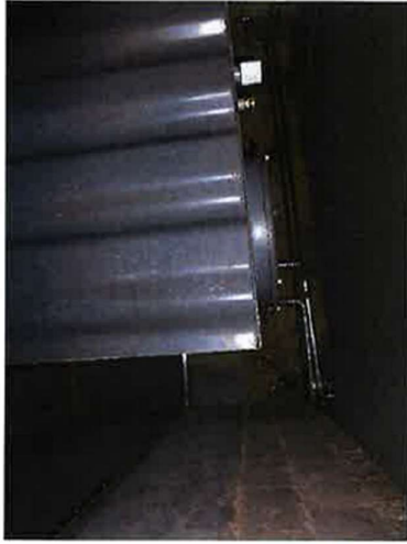
Citerne à mazout
