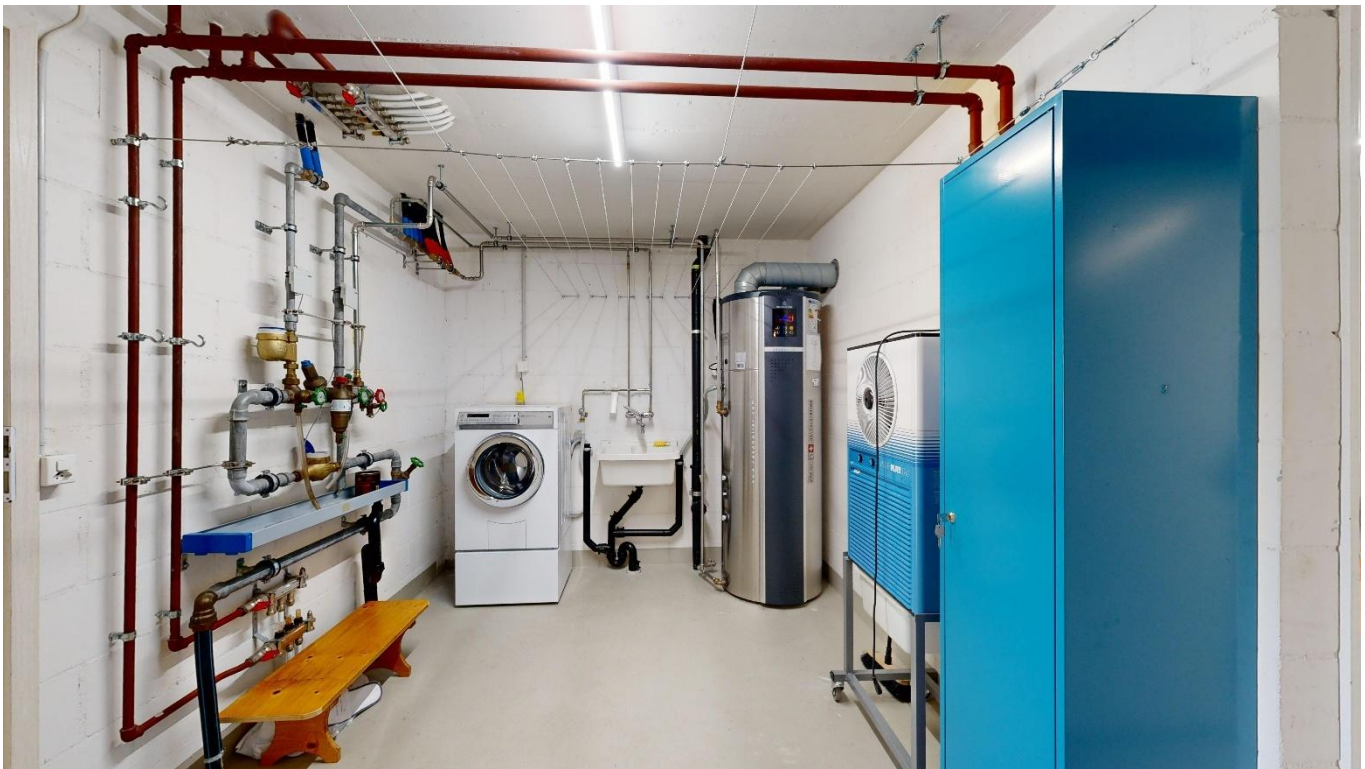
Wasch-/Trockenraum mit Waschmaschine, Lavabo und Secomat (UG)
