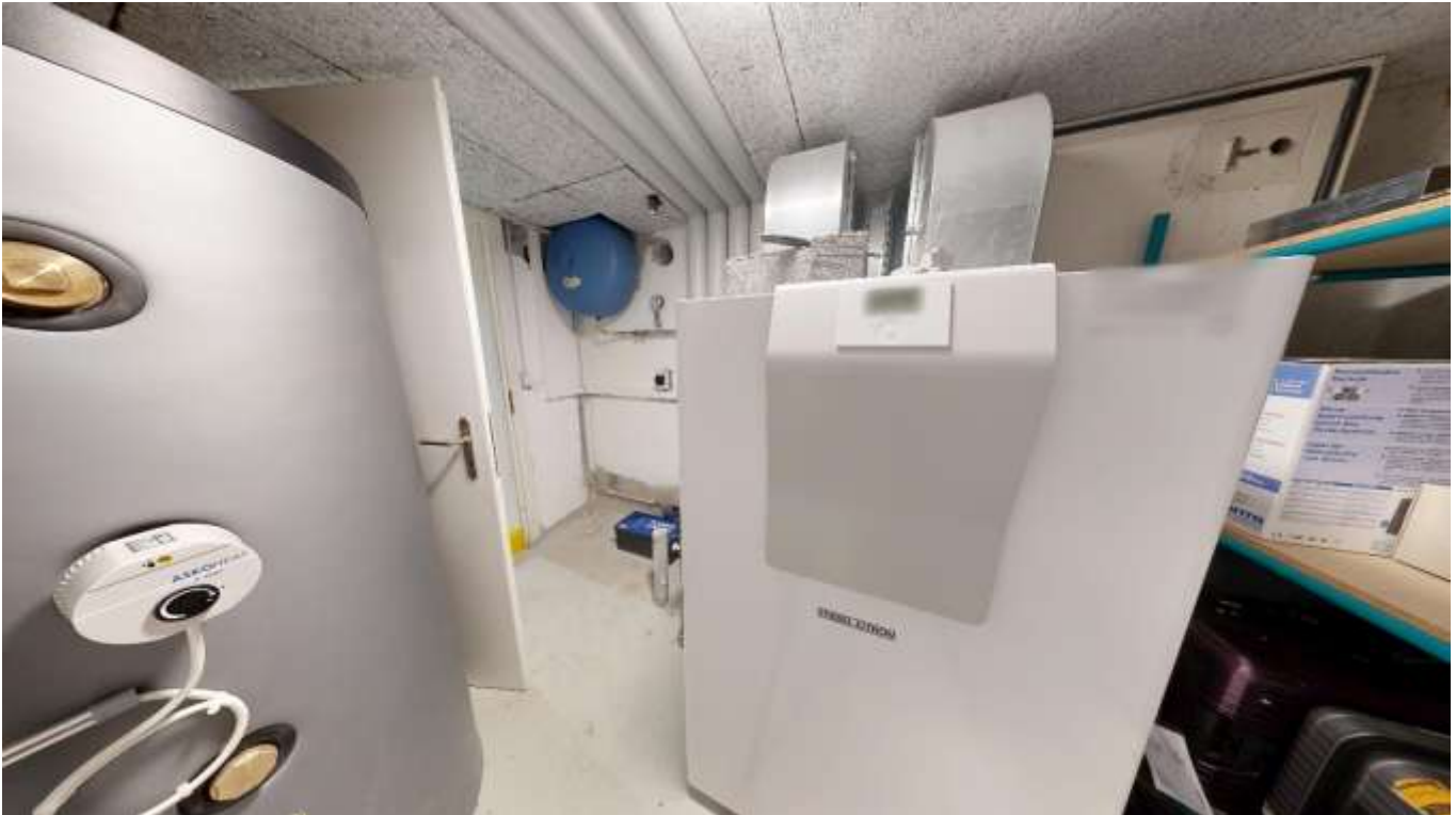
Heizungsraum – früher Luftschutzkeller (UG/Eingangsgeschoss)
