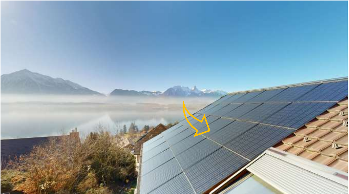
Photovoltaikanlage auf dem Dach (Jahresleistung ca. 6'500 kWh)
