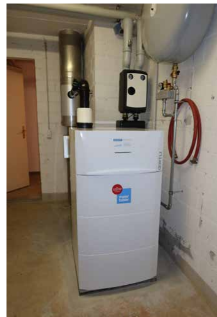
Die Ölheizung, welche vor wenigen Jahren erneuert wurde
