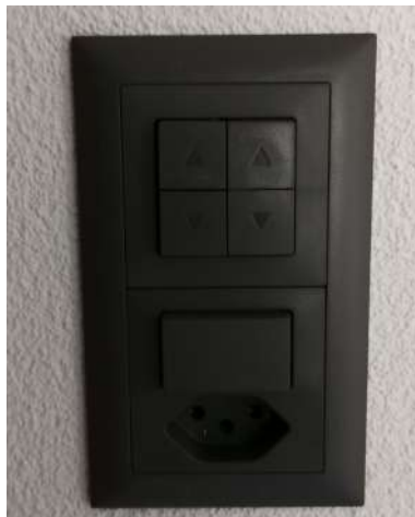
Abbildung 17: Elektrische Installation 1, Archiv Holzbau AG
