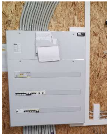
Abbildung 9: Elektrische Installationen, Archiv Holzbau AG
