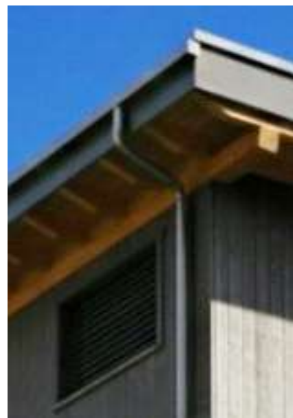
Abbildung 5: Dachrinne MFH, Archiv Holzbau AG
