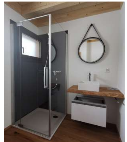
Abbildung 10: Elektrische Installationen, Archiv Holzbau AG
