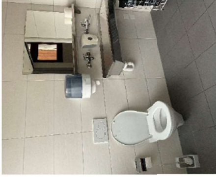
sanitaire WC et boiler
