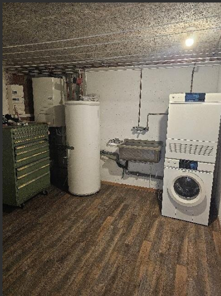
Heizungs- & Waschraum mit Waschturm
