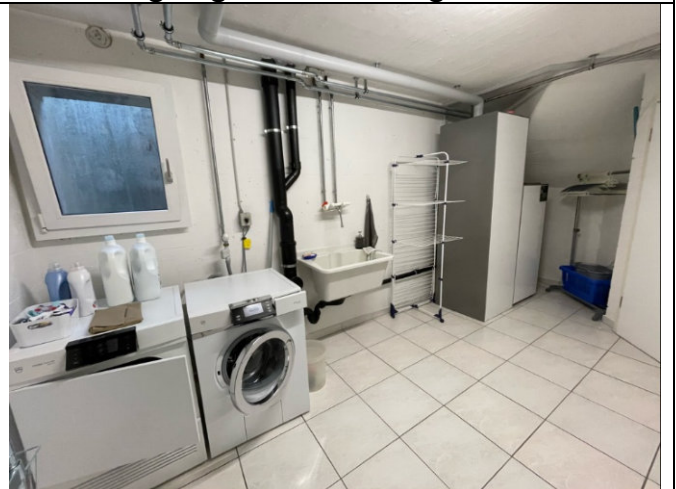
Waschküche / Waschmaschine mit Tumbler von V-Zug / Luft-Wasser-Wärmepumpe im 2022 neu installiert
