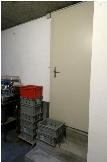
Heizungsraum: Zugang zu Garage
