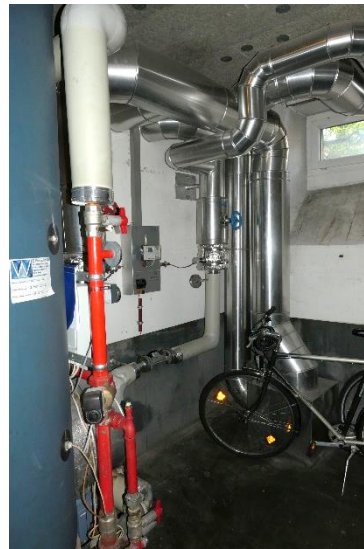
Heizungsraum mit Fernwärme
