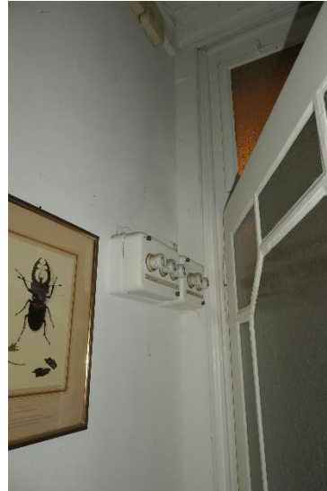
Vorplatz: Wohnungssicherungen alt 1.OG
