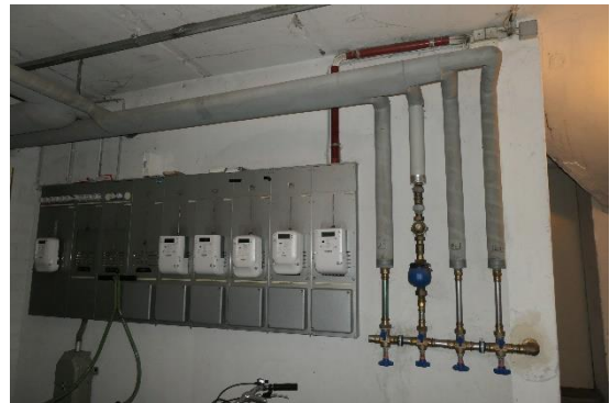
Vorplatz: Elektrotabelleau und Wasser-Verteilung
