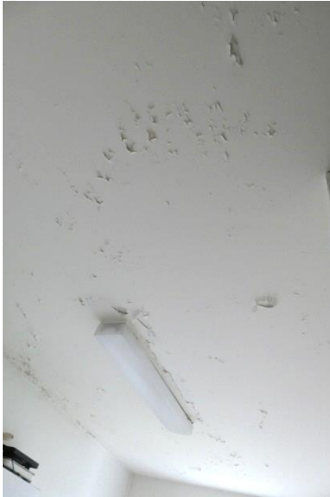
Küche: Decke, Farbabblätterungen
