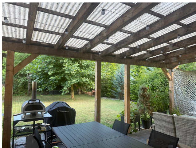
Terrasse couverte sur toute la longueur, sol refait en 2023
