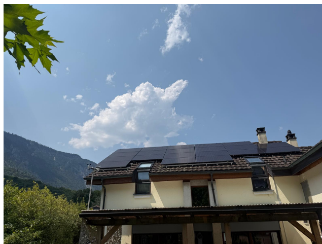
20 panneaux photovoltaïques – 7'500 kWh/an en moyenne
