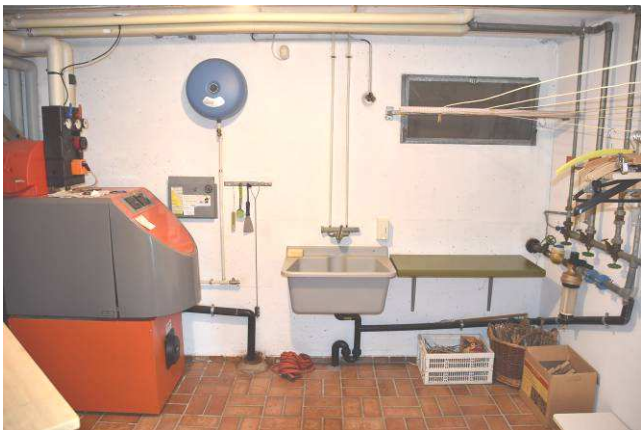
Waschküche mit Heizung
