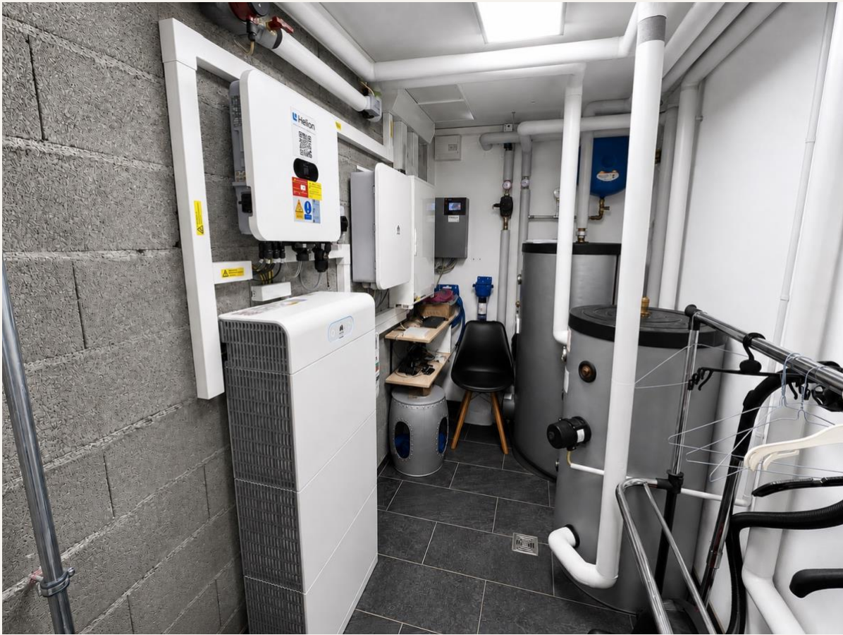
Local technique et installations énergétiques
