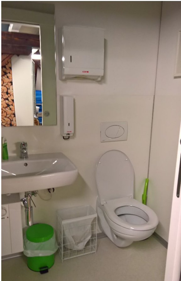
WC-Anlage im Dachgeschoss
