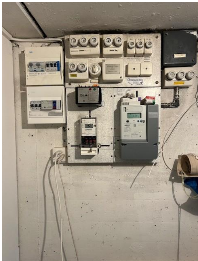
Elektro-Verteilung (Teil-Erneuert mit Einbau WC im UG 2021) Prüfprotokoll vom 9.01.2026 vorhanden
