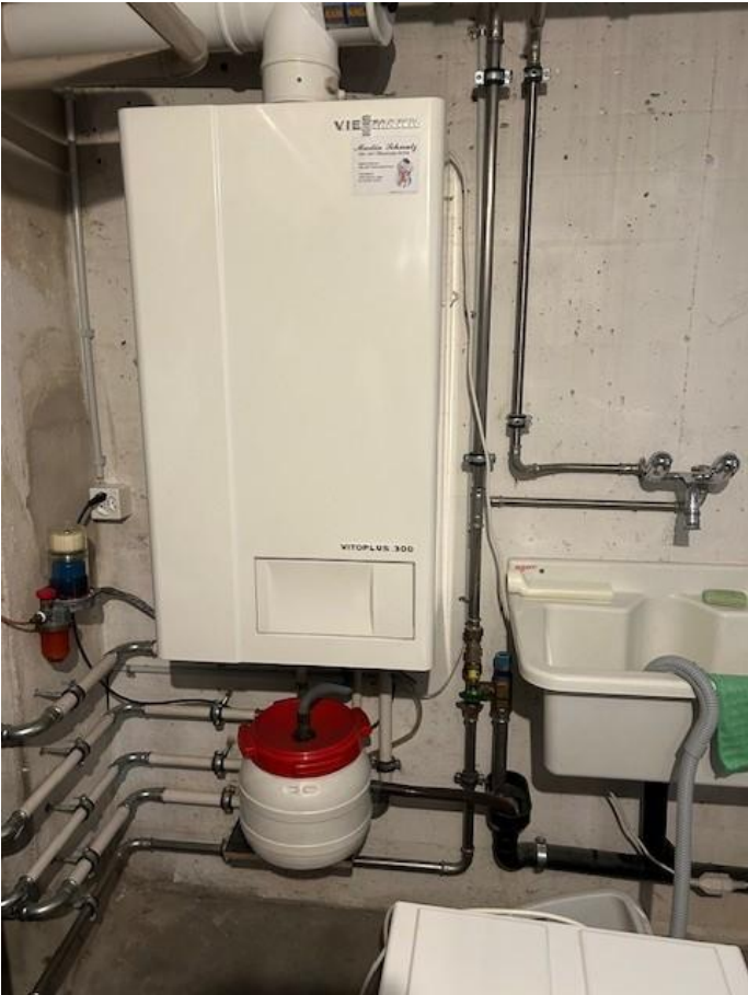
Heizung im Untergeschoss (Oel, Komplettsanierung inkl. Boiler 2005)
