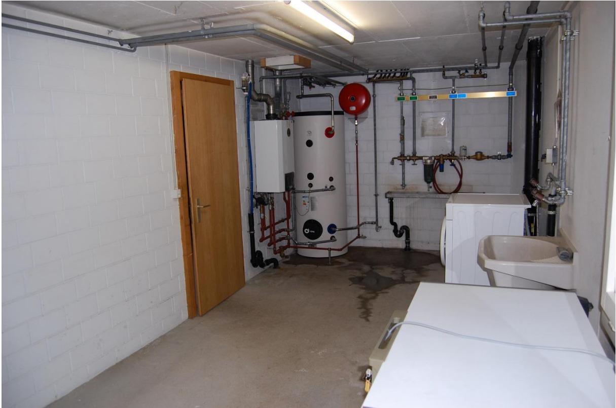
Untergeschoss / Technikraum, Waschküche
