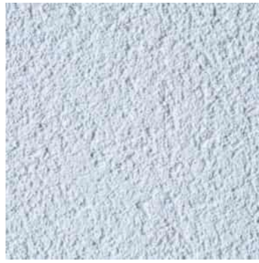
Wand mit Abrieb
