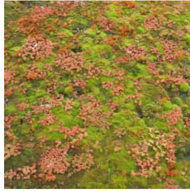
Dachaufbau extensive Begrünung und 30 PV Module auf Kies
