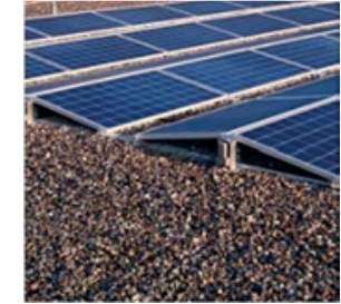
Flachdach Hauptdach Photovoltaikanlage im Modulsystem auf Flachdach
