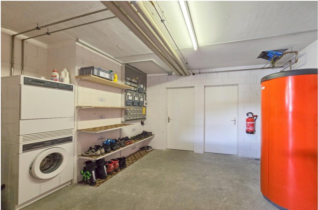
Der Heizungsraum mit integrierter Waschküche (Waschmaschine, Tumbler und Schuhregal)
