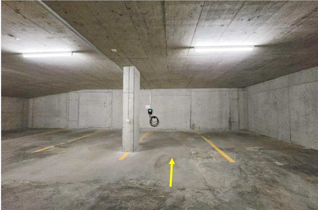
Der Parkplatz in der Einstellhalle mit E-Ladestation
