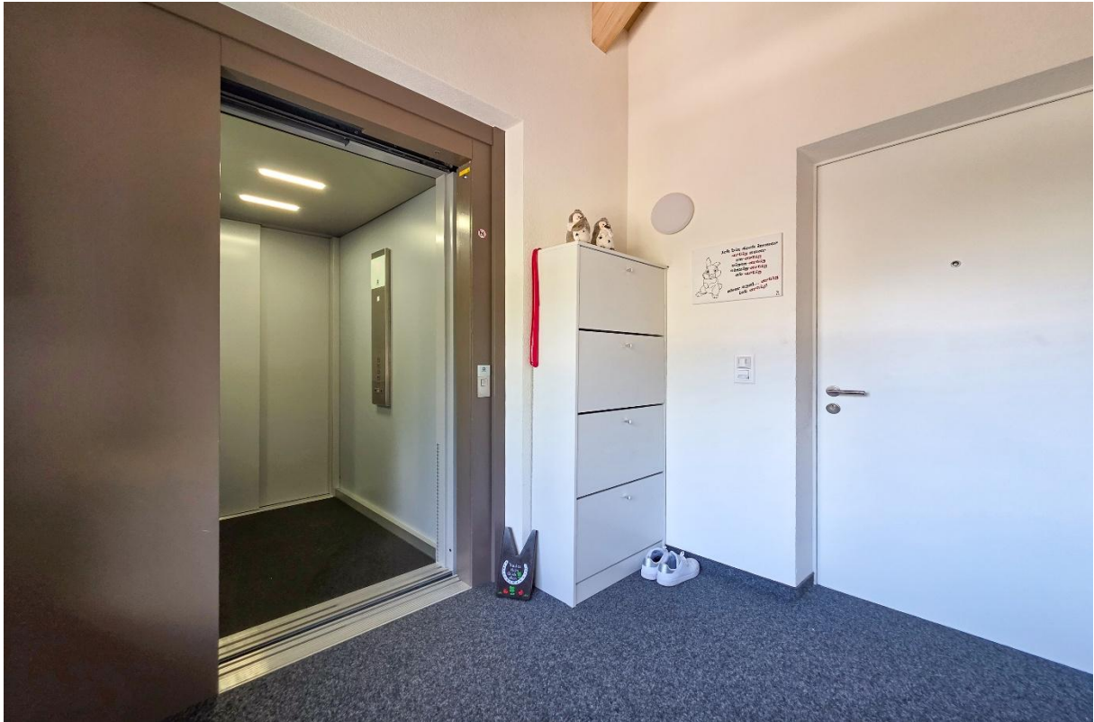
Der Zugang zu der Wohnung mit Lift bequem von der Einstellhalle her
