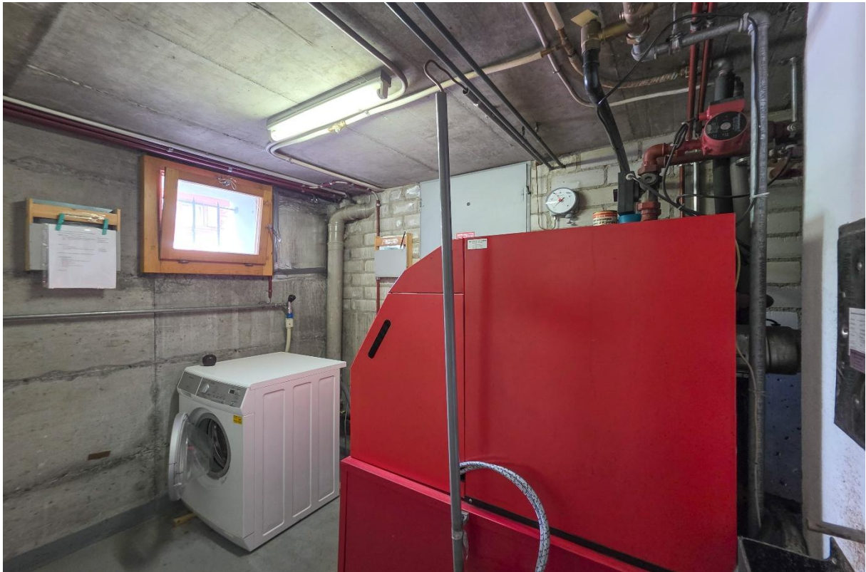
Der Technikraum mit Waschmaschine
