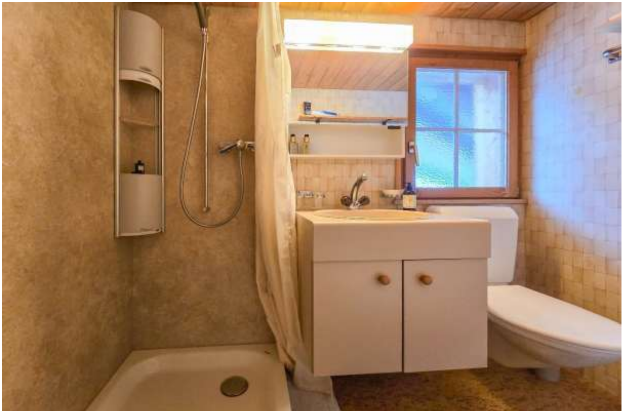
Badezimmer Nr. 2 mit step in Dusche, Handwaschbecken und Toilette
