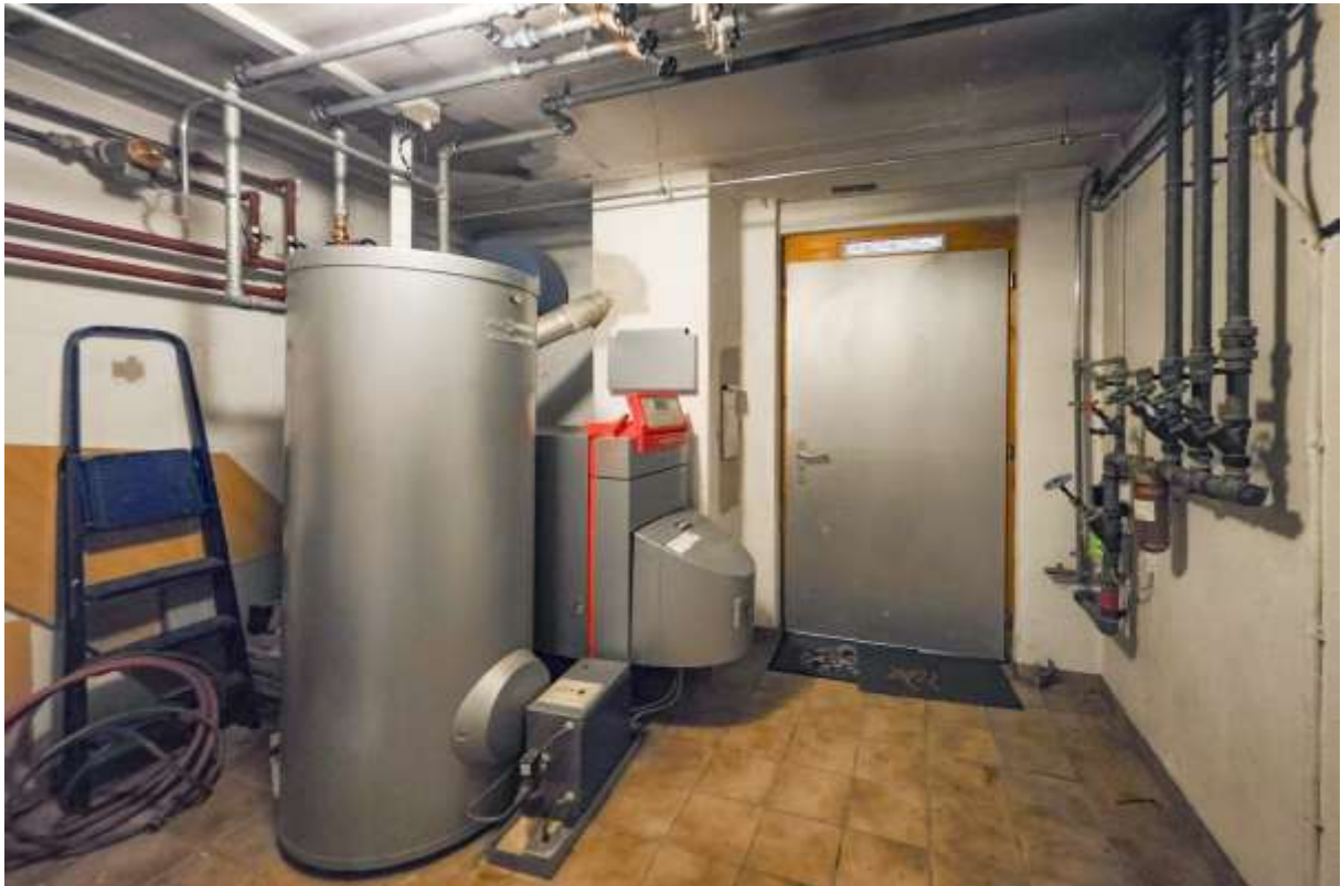
Der Technik- und Heizraum - nebenan befindet sich die Waschküche
