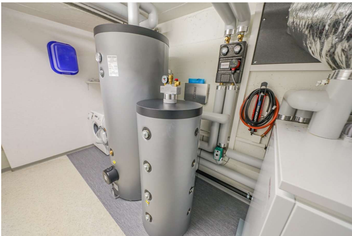
Der Heiz- und Technikraum
