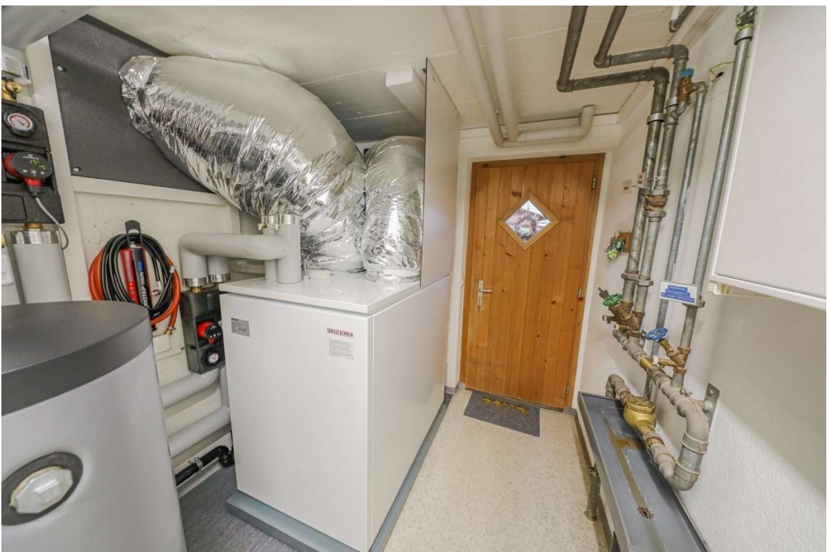
Der Heiz- und Technikraum
