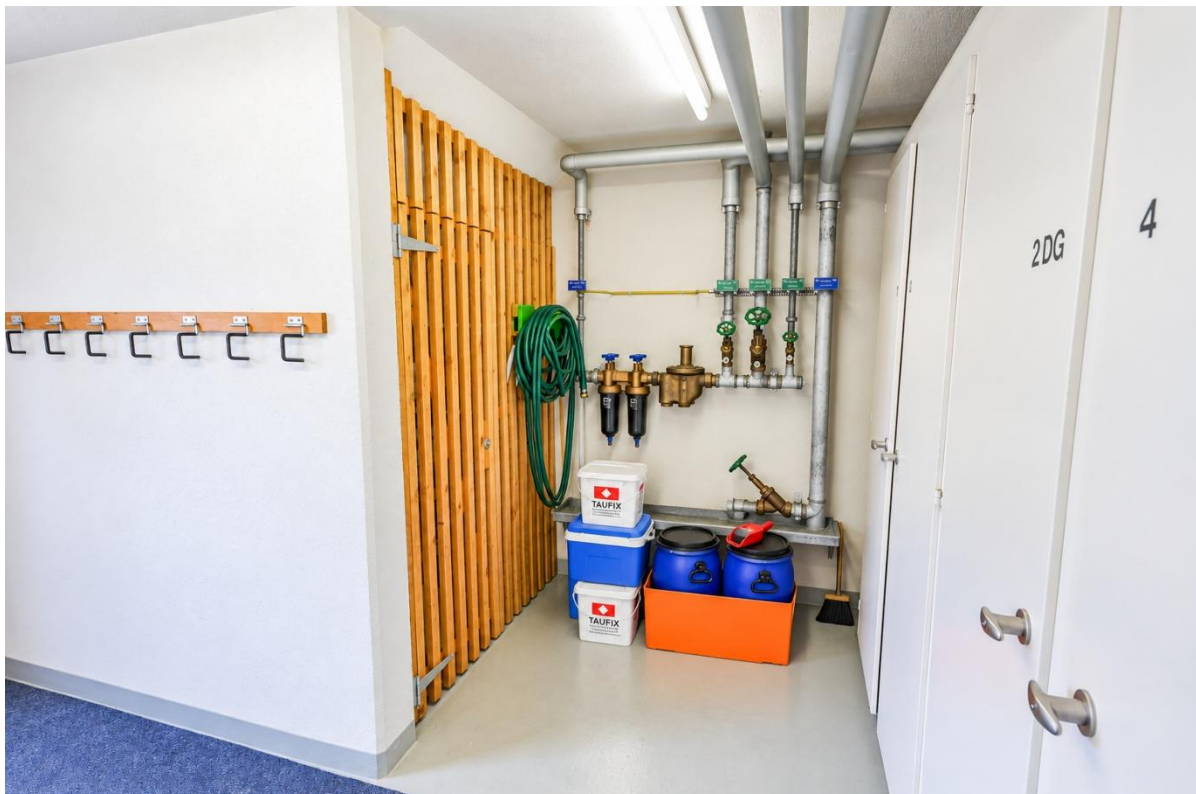
Der Schrankraum und die Wasserverteilung
