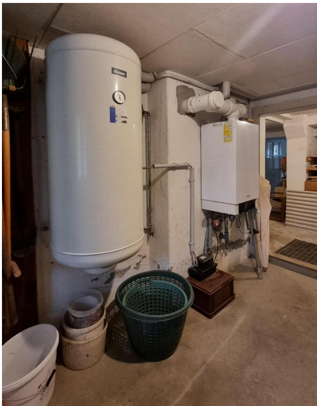
Gastherme mit Boiler
