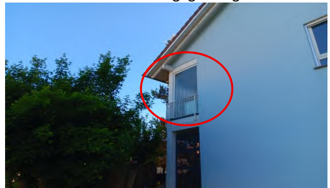
Glasabschluss am Balkon gegen Zugluft
