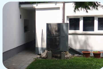
Moderne Wärmepumpe – mit Fussbodenheizung
